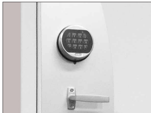
Ytterdörr med högsäkerhetslås med elektroniskt kodlås.
